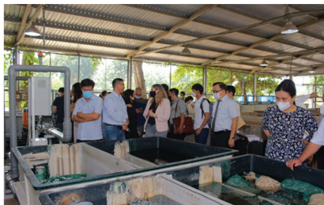
Hệ thống lọc tuần hoàn thủy sản tại Khoa Thủy Sản
